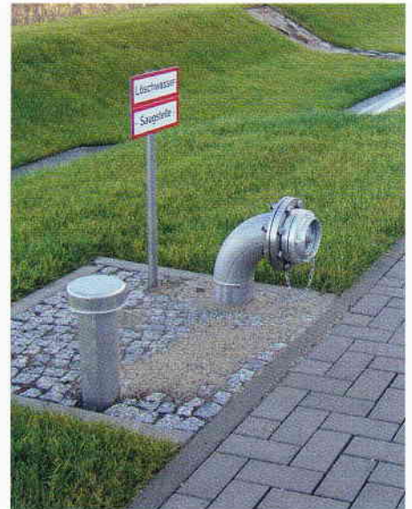
Die Entnahmestelle über einem der vier unterirdischen Löschwasserspeicher.
